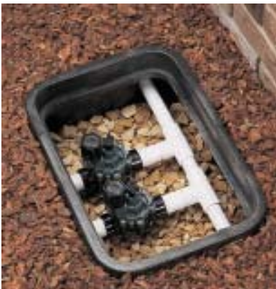
Dois válvulas numa caixa de válvulas. ©2006 Rain Bird Corp.
